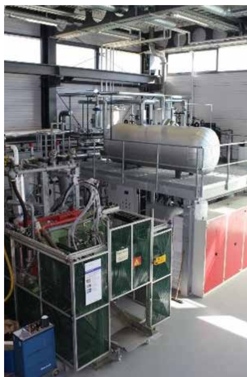
Hochdruck-Dampfversorgung von BBS am Fraunhofer ICT.
